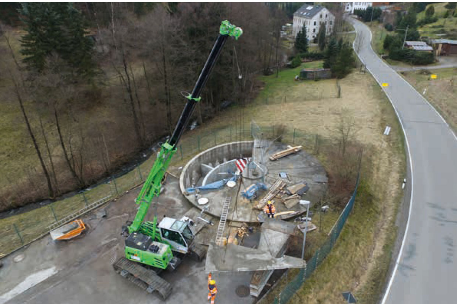
SENNEBOGEN 613 E Raupen bewegt und hebt Lasten beim Bau einer provisorischen Kläranlage in Deutschland.
