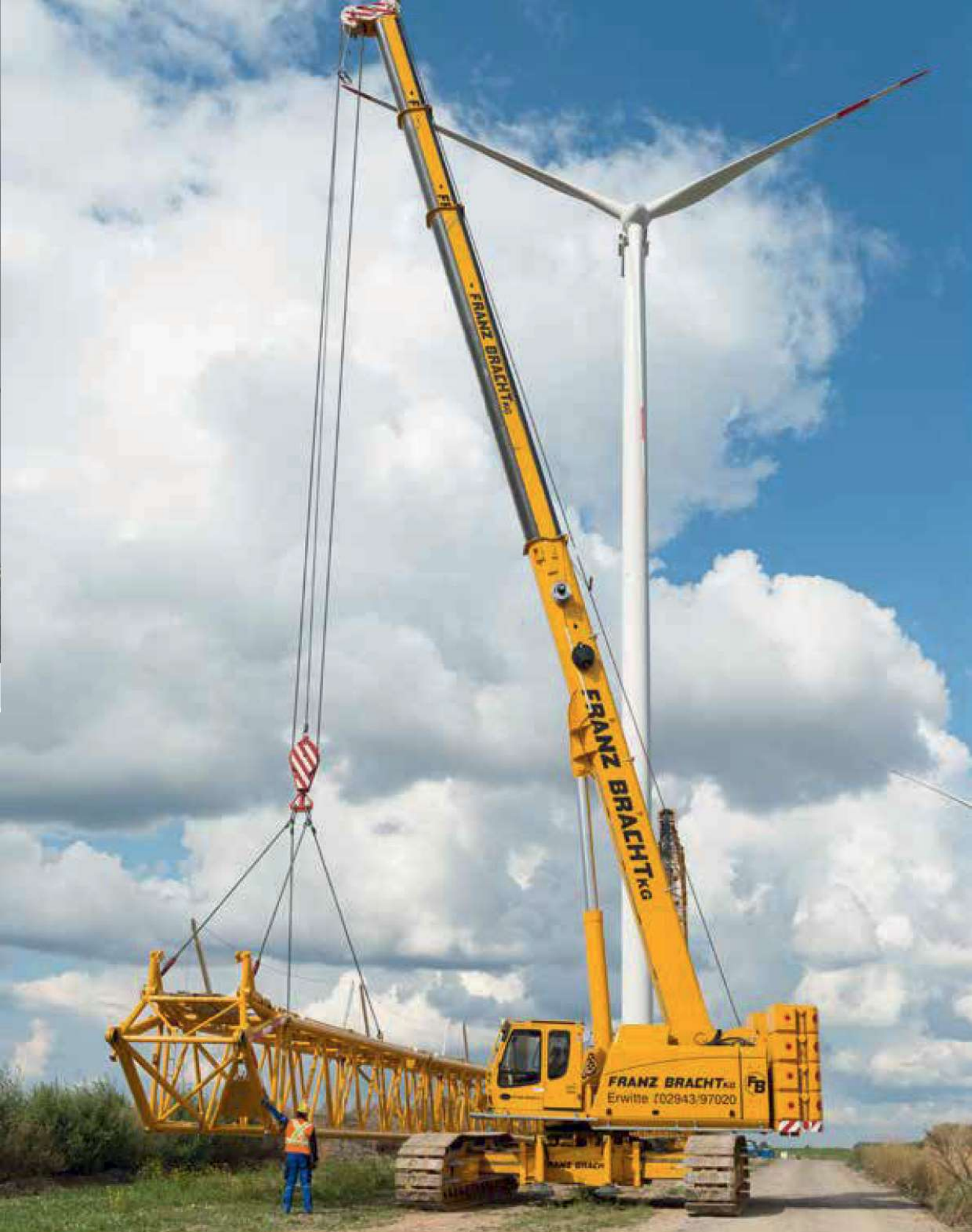
6113 R - used as a flexible service crane in wind energy; Germany 6113 R - im Einsatz als flexibler Service-Kran in der Windenergie; Deutschland
