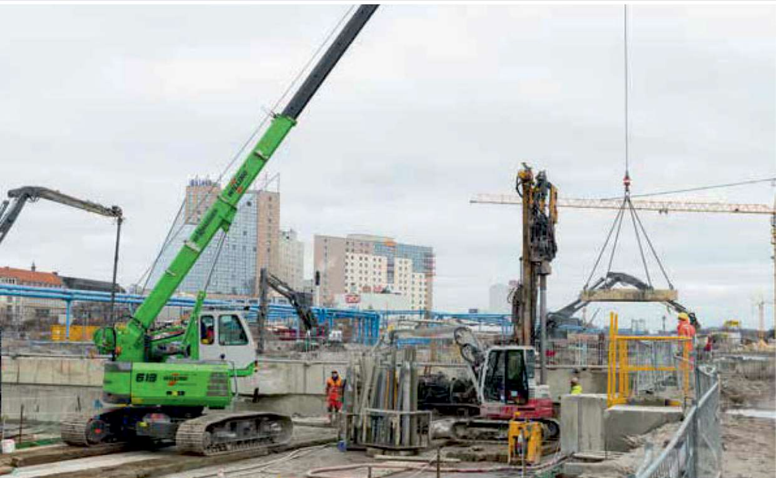
613 R - safely position loads on poorly accessible construction sites; Germany 613 R - Lasten sicher positionieren auf schlecht zugänglichen Baustellen; Deutschland
