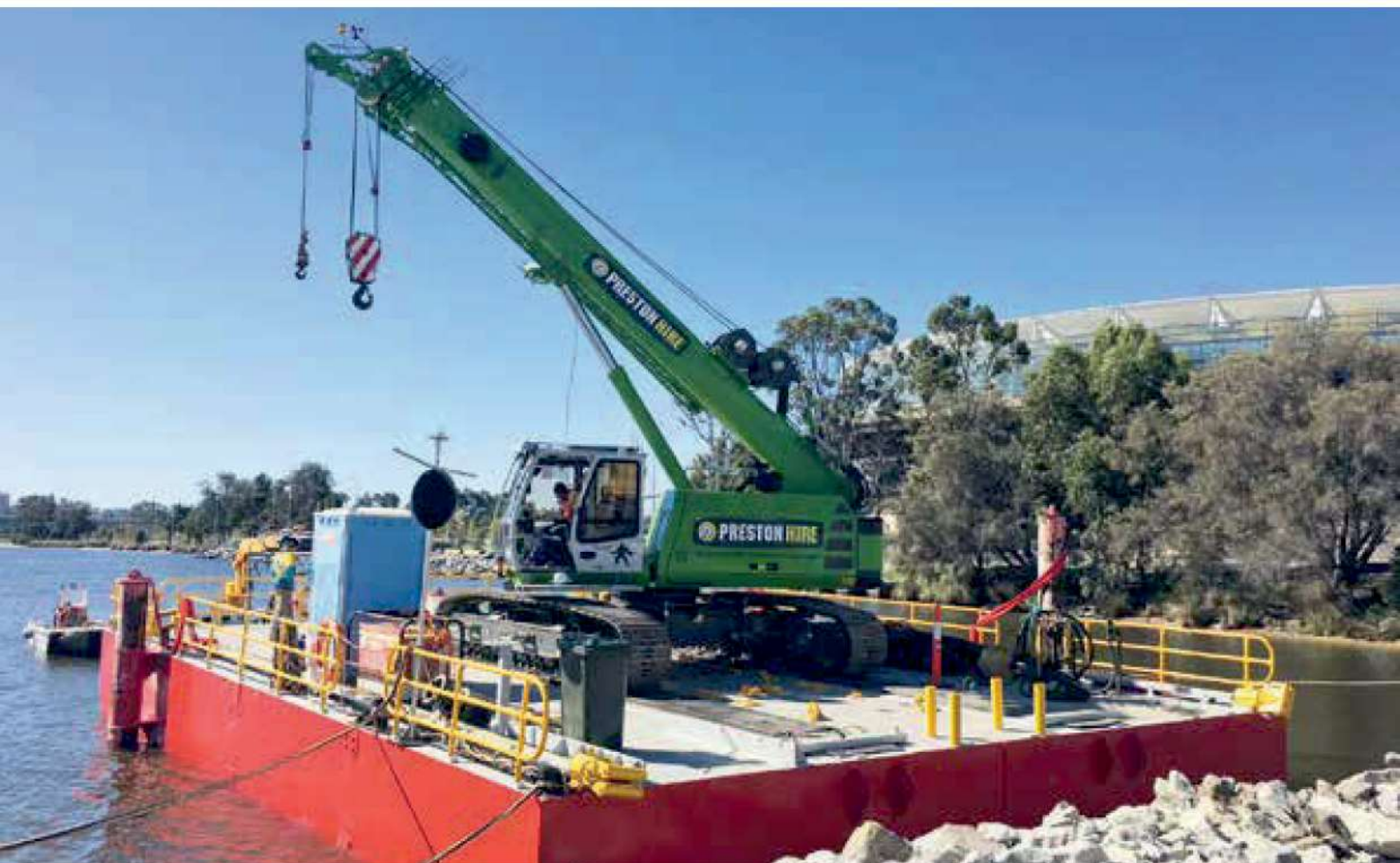
54 643 R - hydraulic engineering on a barge; Australia 643 R - Wasserbau auf Ponton; Australien
