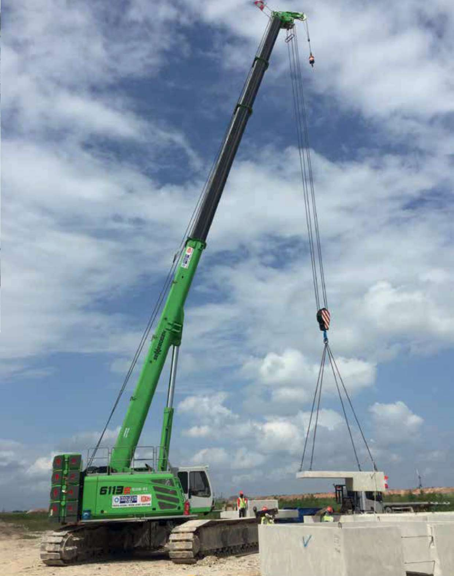
6113 R - truck loading and unloading with precast concrete parts; Singapore 6113 R - LKW Be- und Entladung mit Beton-Fertigteilen; Singapur
