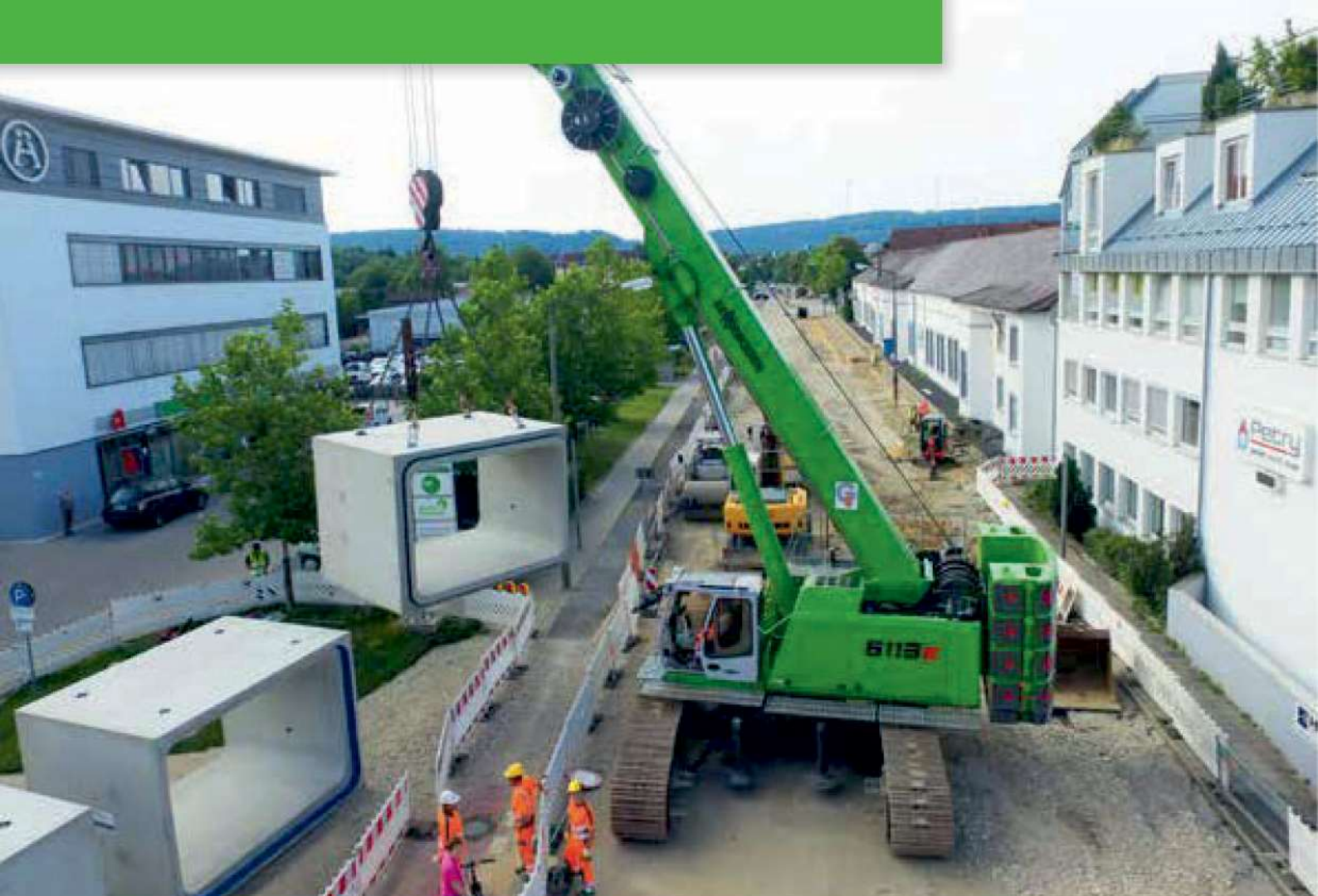
6113 R - moving and positioning large and heavy components in civil engineering; Germany 6113 R - große und schwere Komponenten verfahren und positionieren im Tiefbau; Deutschland
