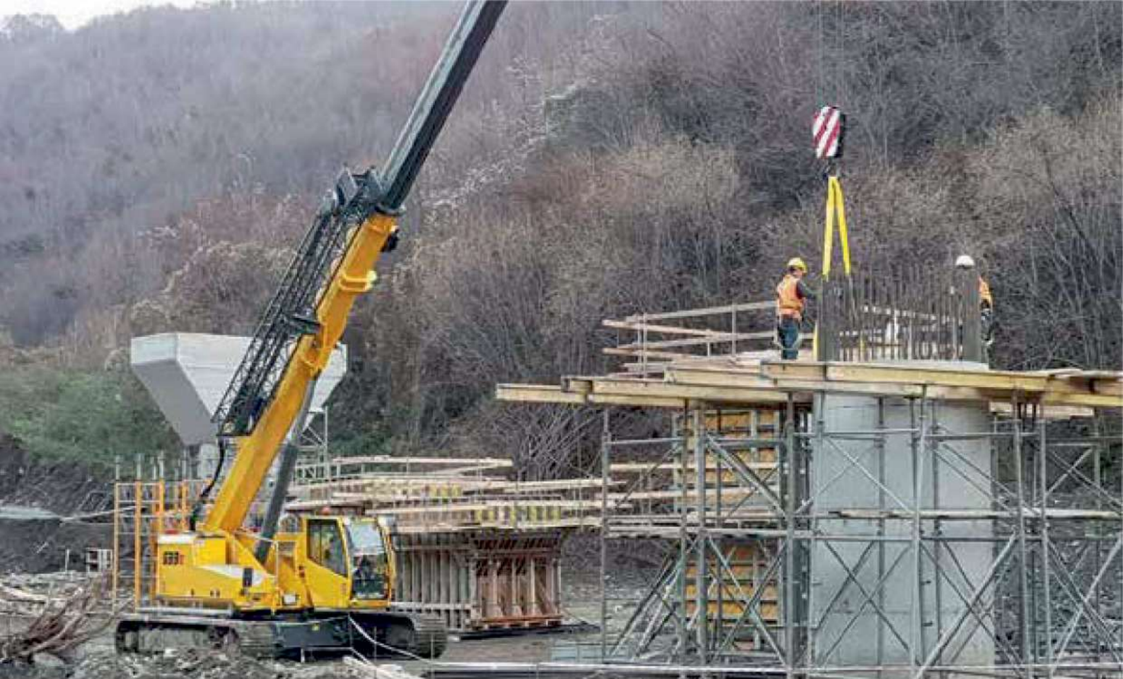
633 R - hoisting crane on difficult terrain in bridge construction; Kosovo 633 R - Hebekran auf schwierigem Untergrund im Brückenbau; Kosovo
