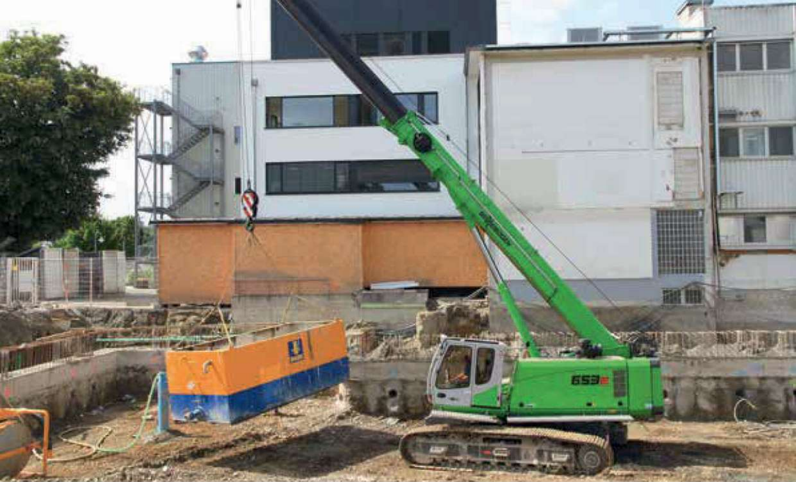
653 R - Pick & Carry with loads on the construction site; Germany 653 R - Pick & Carry mit Lasten auf der Baustelle verfahren; Deutschland
