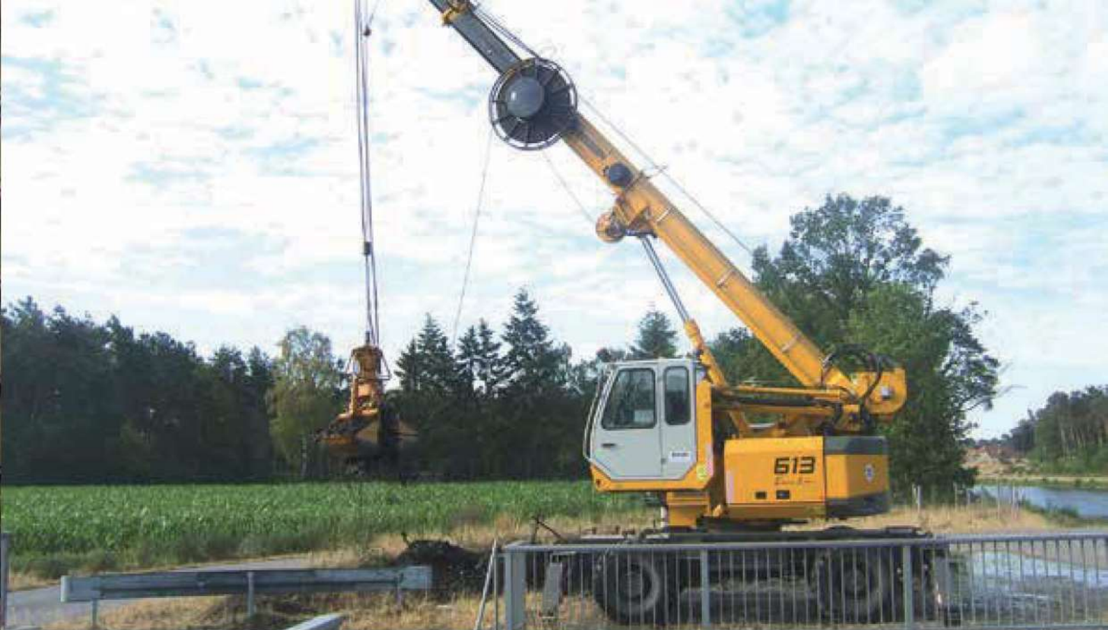
613 M - clamshell operation in hydraulic engineering; Germany 613 M - Zweischalengreifereinsatz im Wasserbau; Deutschland
